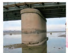
コンクリートが劣化した橋の一部
