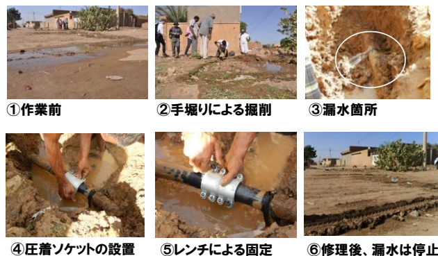
図 3-1-2. 圧着ソケットによる漏水への対応
