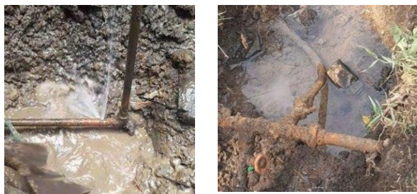
写真9 漏水調査により見つけた漏水（一例）
