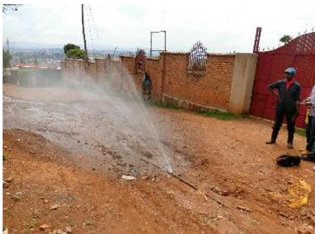
写真：漏水発生の様子
