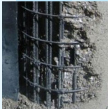
चित्र १८: निरीक्षणका क्रममा काँक्रिट सतहमा खाल्टो, ठूलो खाली भाग वा हनिकम देखिएको
