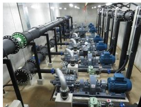
Sala de Bombas
