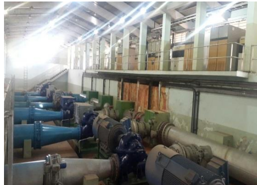
Sala de Bombeo - Viñas Cue
