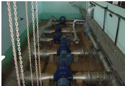
Sala de bomba Centro de Distr. Loma
