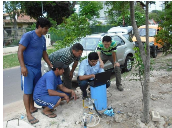
Control de presión de agua
