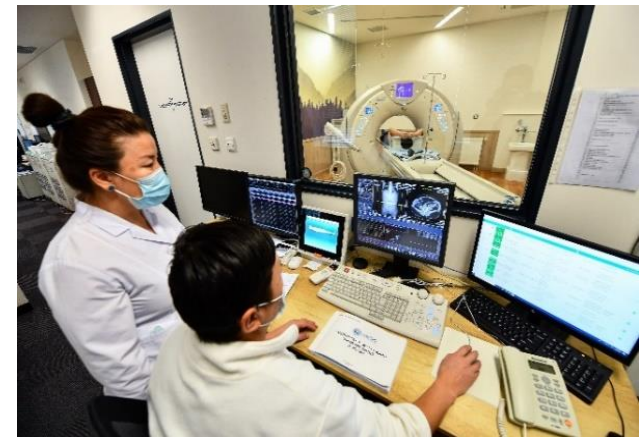
日本製のMRI、CT等画像診断装置を設置
