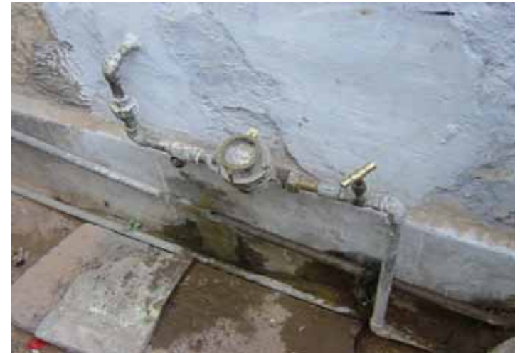
漏水のひどい末端配水網とサービスマーター
