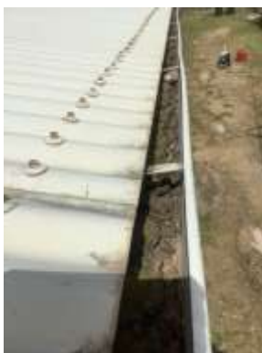
雨樋に溜まった汚れ
