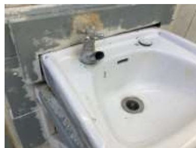
塩害で腐食した蛇口
