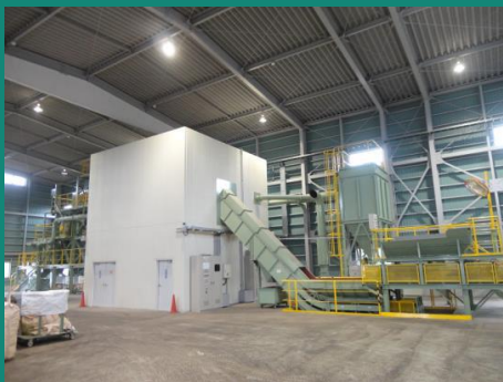
電気電子機器廃棄物からの 金属類回収設備
