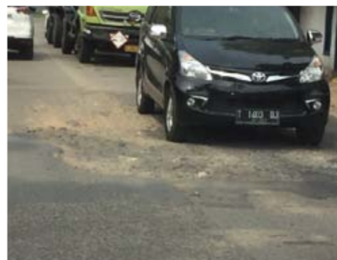
インドネシアの劣悪な道路状況。循環型舗装技術により、安全な道路整備と、天然資源使用削減やそれに伴うエネルギー使用削減で、ライフサイクルコストの削減になるとの期待は大きい
