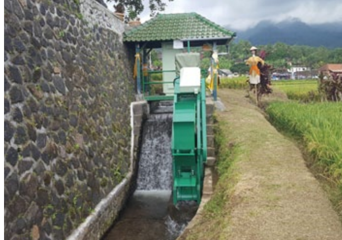
完成した小水力発電装置。事業では4カ所に設置した。発電量はそれぞれ異なり、0.15~5キロワットを見込んでいる。日中に発電してバッテリーに蓄電し、夜間、街灯へ電力を供給する。
