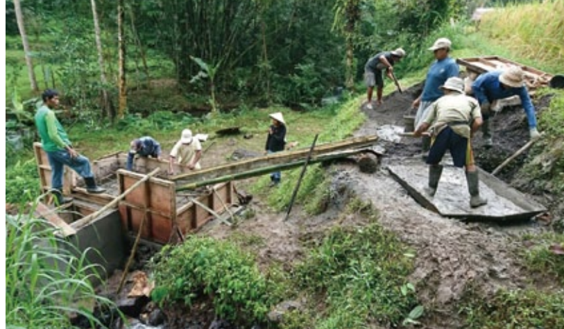
小水力発電用の水車の建設風景。水車は現場の水路状況にあわせて3種類から選定。ほとんどを手作業で行ったが、地元組織「スパック」の協力もあり、滞りなく建設することができた。
