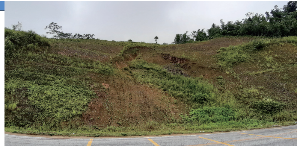
緑化に取り組んだが草が生えずにのり面が崩壊。現地の政府機関より、日本の技術にて緑化可能かという調査依頼を受けた
