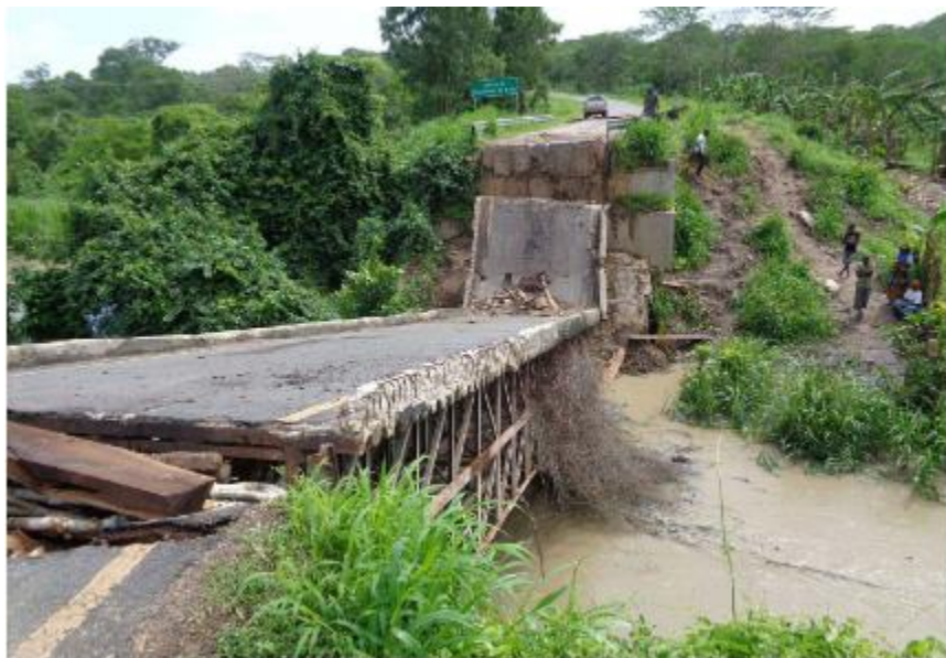
崩落した橋梁
