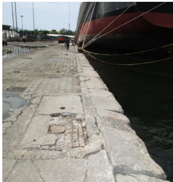
損傷・老朽化した岸壁
