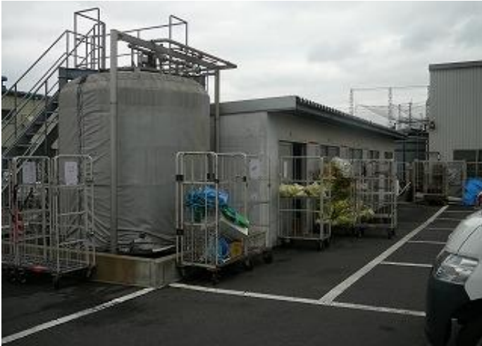
饲料化设施外观（左侧靠前为发酵罐）
