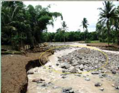
Foto kerusakan Dam Ampel
