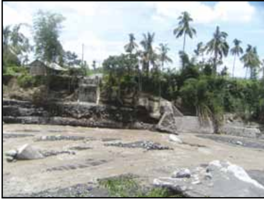
HANCURNYA JEMBATAN TLATAR AKIBAT HANTAMAN BANJIR LAHAR
