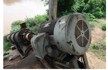
ຈັກສູບນໍ້າຊຸດໂຊມທີ່ເປັນໜາກຫົວໃຈຂອງລະບົບຊົນລະປະທານ
