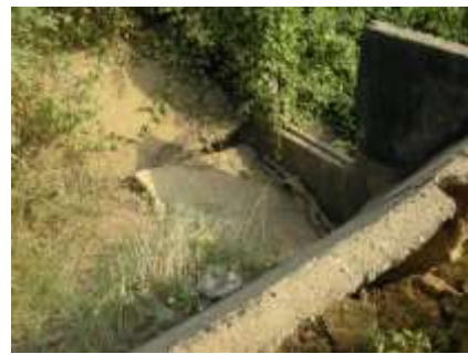
写真：床板崩落
