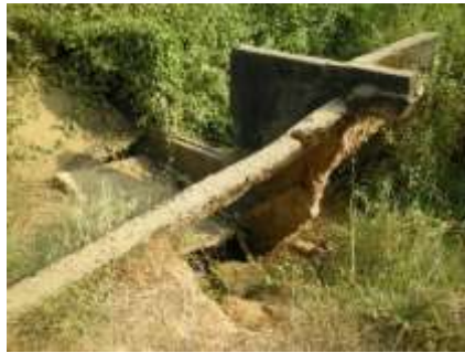
写真：落差工崩落状況（背面浸食）
