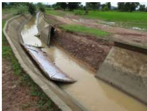
写真:研修用水路損傷個所
