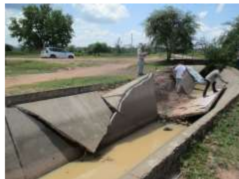
写真:研修用水路損傷個所
