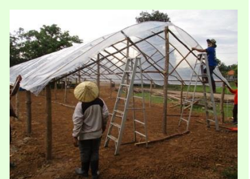
ຜ້າຢາງແມ່ນໄດ້ຍືມຈາກໂຄງການ ແຕ່ວ່າໂຄງສ້າງໄມ້ ແລະ ການຕິດຕັ້ງແມ່ນຂຶ້ນກັບຊາວນາເອງ
