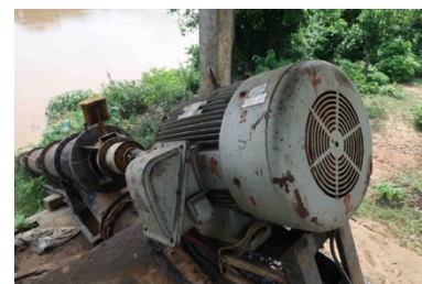
老朽化したポンプ ポンプは灌漑施設のライフライン
