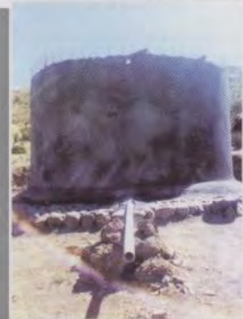
Tanque de Ferrocemento Depto. La Paz. Comunidad Jancko Marca Sirpa. Munc. Coro Coro.
