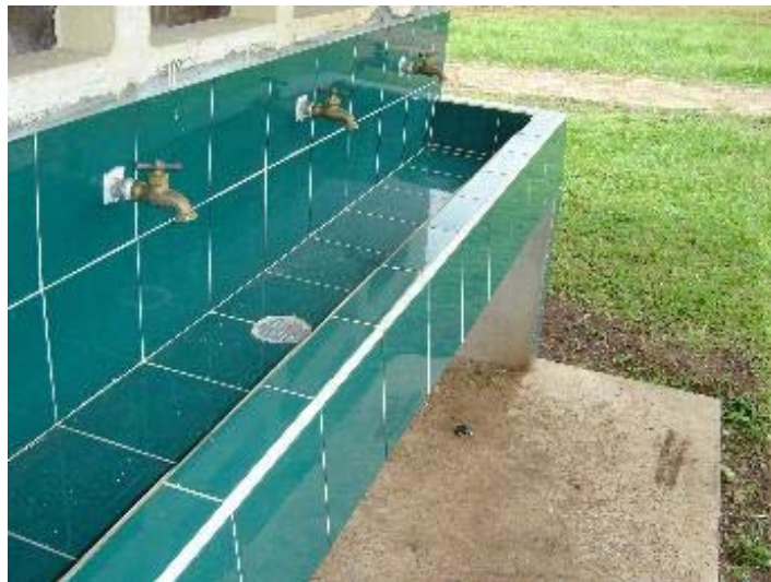
Fotos 25. Lavamanos escolares.
