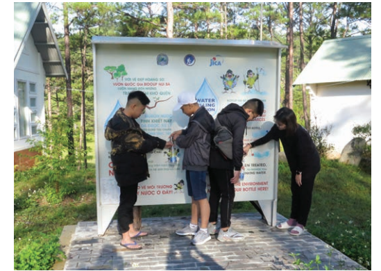
Hệ thống lọc nước
