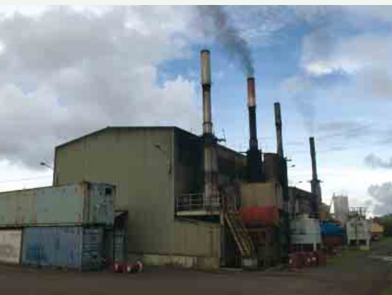
サモア・アピア市内にある老朽化した火力発電所。円借款を通じて新設される予定(撮影:今村健志朗)
