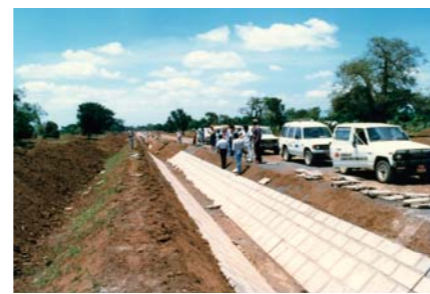
(上)1970年代から水路の設置が行われ、今ではキリマンジャロのふもとに水田地帯が広がる (下)1980年代に行われた幹線水路のブロックライニング工事の様子(写真提供:日本工営株式会社)
