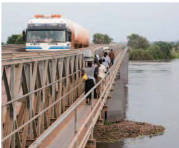
南スーダンの首都ジュバとケニアなどをつなぐ幹線道路にある仮設のジュバ橋。老朽化が著しく崩落の危険もあるため、上流に新ナイル架橋を建設する
