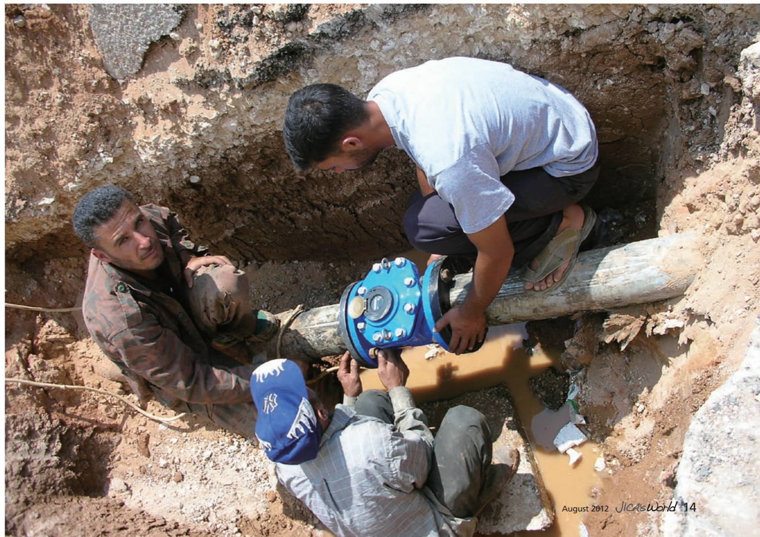
各地域に水を送る配水管に、水道庁の技術者が流量計を設置
