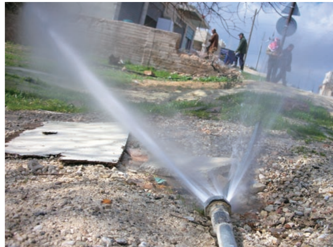
配水管が地上に敷設されている場所では、車などの振動の影響で継ぎ目がゆるんで水が漏れてしまうこともある
