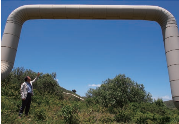
キリンも通れる地熱発電のパイプ
