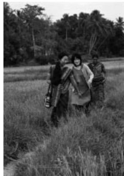
建設中の障害児幼稚園の現場を確認するためにあぜ道を行く加藤さんたち。成人でさえ歩きにくい場所での建設が始まり、雨期の通園が気がかりだ。幼稚園が新設されることは地域にとって朗報だが、まだまだ課題も多い
