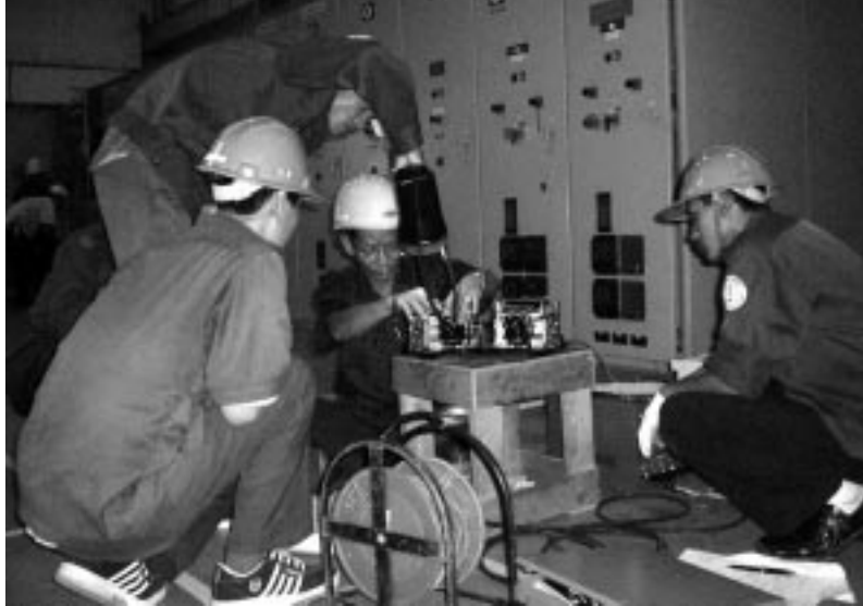
浄水場の電気設備のメンテナンス作業をするPPWSAの電気施設担当職員たち。フェーズ1で育成されたPPWSAの職員が、フェーズ2の研修講師を務める
