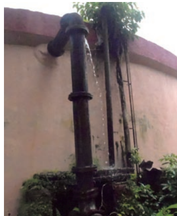
配水管の継ぎ目から水が漏れている。放っておけば貴重な水が無駄になってしまう
