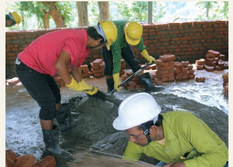
小学校の修復工事の現場。日本の建設会社がネパール人作業員と共に進めている
