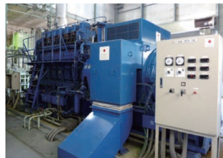
ビケネバウ発電所(キリバス)では、日本製の発電機が活躍している
