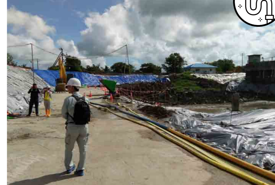
上：ヤンゴン市東部のラウンピン浄水場建設地。浄水場の関連設備である送水ポンプや監視制御システムをはじめ、送水管・配水管の敷設などをJICAが協力した。右：水道管へのバルブ・流量計取り付け技術などを学ぶYCDCの職員。福岡市水道局や東京都水道局の職員などがアドバイザーとして現地に派遣されている。
