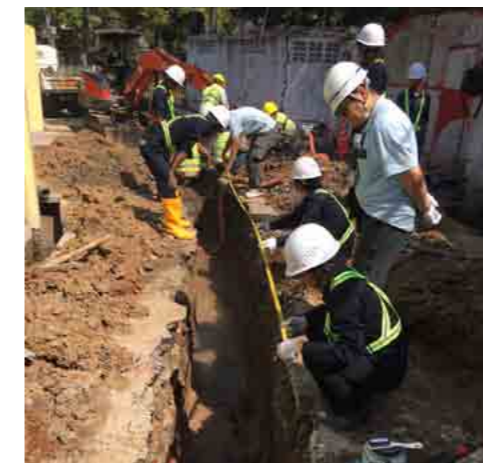
漏水などによる無取水が多ければ水道料金の徴収はままならない。2013年からJICAは老朽化した送配水管の改良にも協力。実施中の技術プロジェクトでも無取水対策を支援する。
