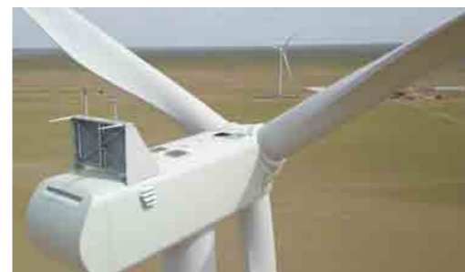
上：ツェツィー風力発電所の変電所。電圧を調整する施設。下：風車1基あたりの出力は約2メガワット。年間を通して偏西風が吹くゴビ砂漠は風力発電に適している。
