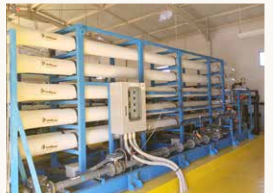
類似案件である日本の無償資金協力 (2010年～2013年) によってチュニジア南部メドニン県に建設された地下水淡水化施設内部。
