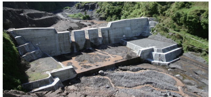
メラピ山麓に建設された砂防ダム (Photo: 八千代エンジニアリング株式会社)
