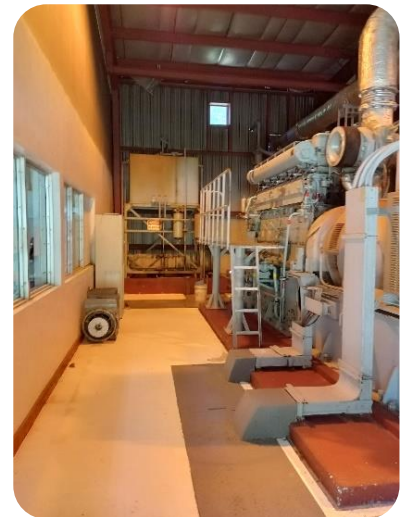
発電所の様子
