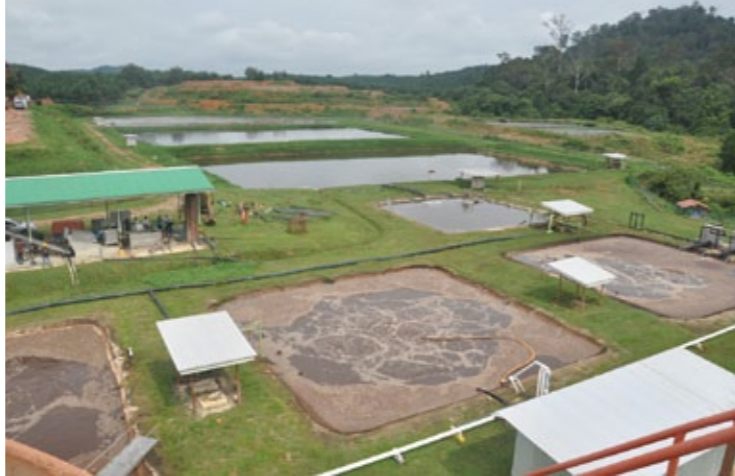
反応槽の全体像。写真は槽内に設置したアクアレータで曝気・攪拌を行っているところ。これにより排水中に絶えず空気を送り込み、微生物を活性化させて浄化を図る。
