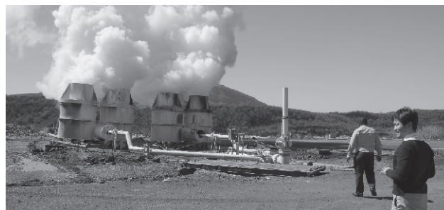
Kenia: Energía geotérmica en Menengai
