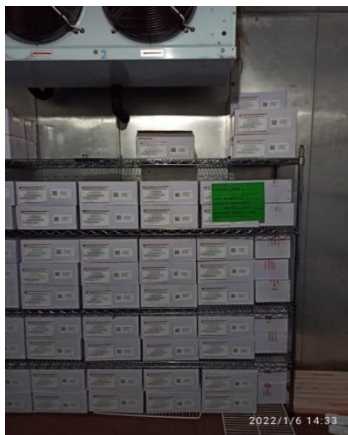
Almacenamiento de vacunas en cámara fría.
