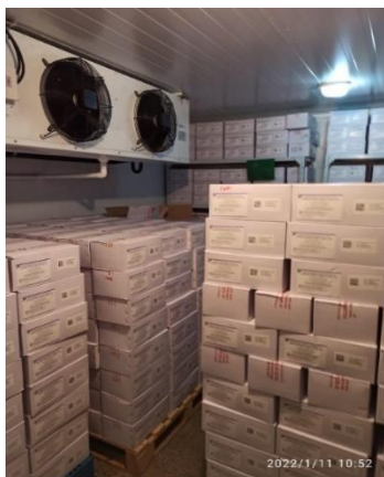
Almacenamiento de vacunas en cámara fría
