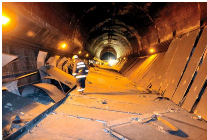
Colapso del túnel Sasago en dirección a Tokio (Dic. 2012)
