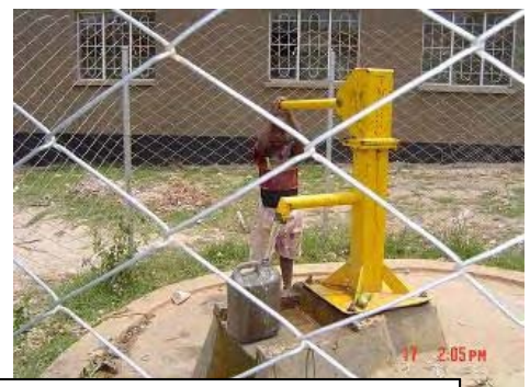
Ruhunga 郡深井戸(子供でもポンプ可能)
