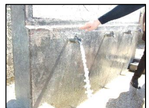
日本の無償資金協力による 共用の水道
