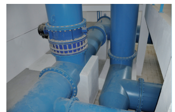
Chambre des vannes de réservoir 5000m 3
