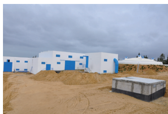
Réservoir 1000m 3 , Station de pompage et transformateur
