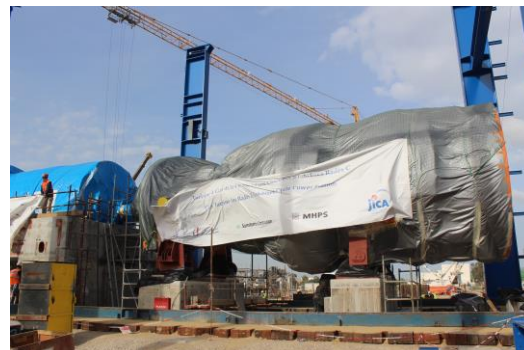
Turbine à gaz et son alternateur
