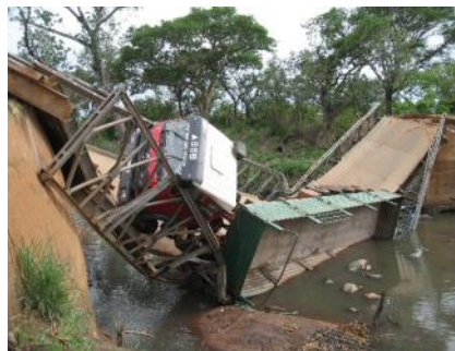
橋梁の落下現場
