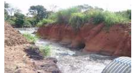
洪水の影響のもと見られる水路法面の侵食状況
