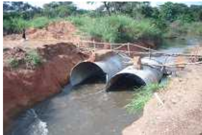
迂回水路の現況(洪水直後)
